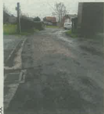
La rue de Bodegnée est particulièrement abîmée, sa réfection ne sera pas du luxe.
